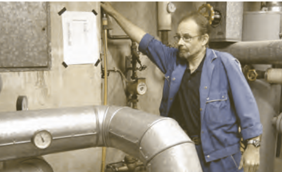
Hausverwalter Gerd Grotthaus beim Nachfüllen von Wasser in die Heizungsanlage der AKAFÖ-Wohnanlage Markstraße 105.
